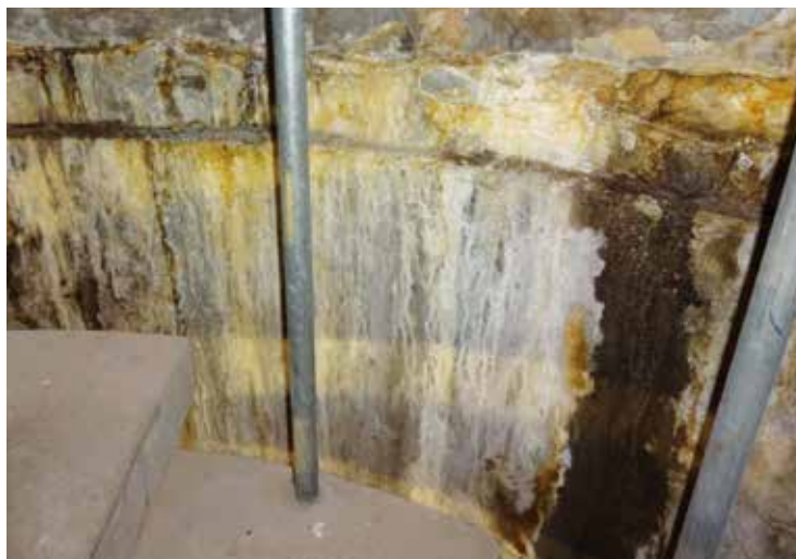
Undichtigkeit im Bereich der inneren Wasserkammer zum Treppenaufgang
