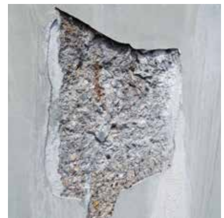
Flächige Betonabplatzung mit großen Aussinterungen
