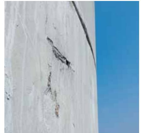
Abb. links: Großflächige Aussinterungen im oberen Bereich der Wasserkammern
