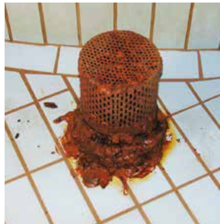
Korrodierte Entnahmestutzen in der Wasserkammer
