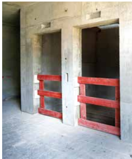
Absturzsicherung am Fahrstuhlschacht
