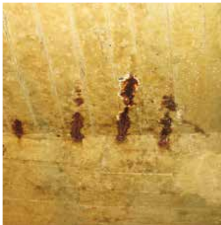
Freiliegende Bewehrung an der Decke der Wasserkammer
