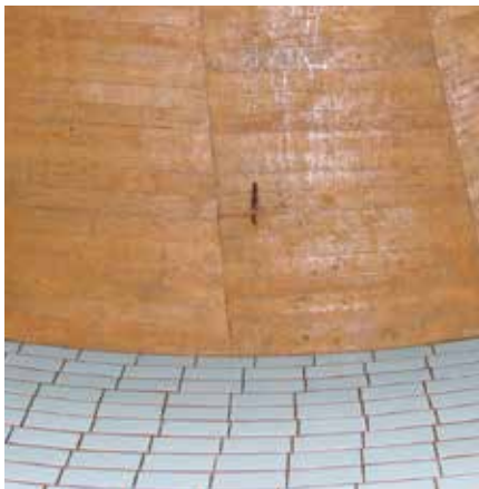
Gefließte Außenwandfläche der äußeren Kammer, Korrosionsschäden an der Betondecke
