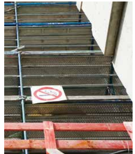
Rauchverbot gilt auf der gesamten Baustelle
